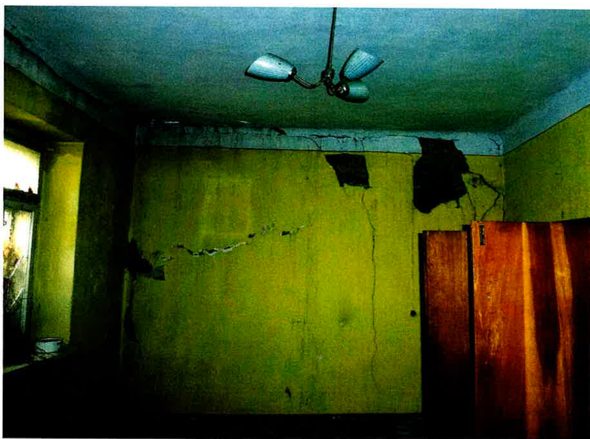
FOT.12 – ODKROJONA ŚCIANA OD STROPU. SZCZELINA W ŚCIANIE KONSTRUKCYJNEJ POŁU- DNOWEJ
