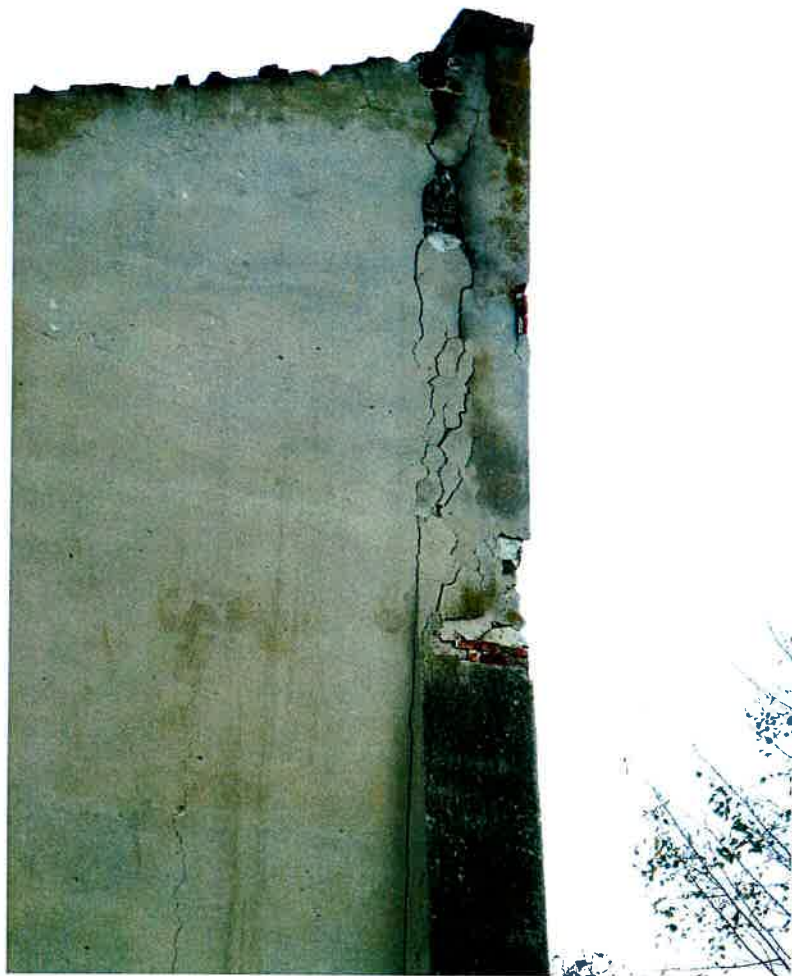
FOTO.5 – ZARYSOWANIE ORAZ OD- KROJENE SIĘ ŚCIANY KONSTRUK- CYJNEJ WSCHODNIEJ I PÓŁNOCNEJ
