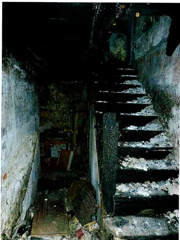
FOT.7 – SPALONA KLATKA SCHODOWA
