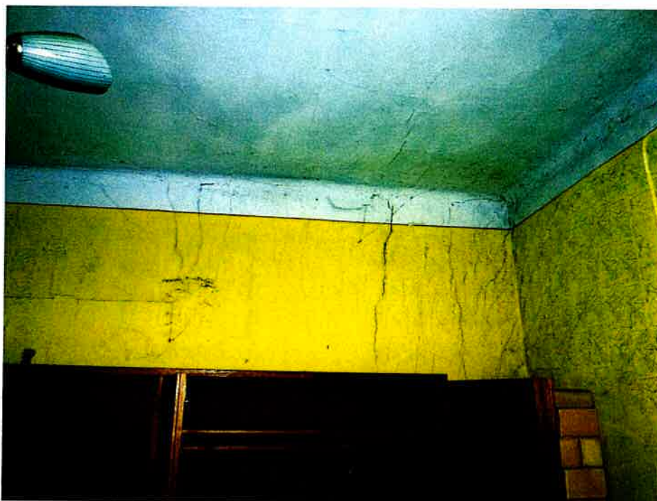
FOT.11 – PLEŚŃ NA ŚCIANACH I SUFICIE POMESZCZENIA PAR- TERU
