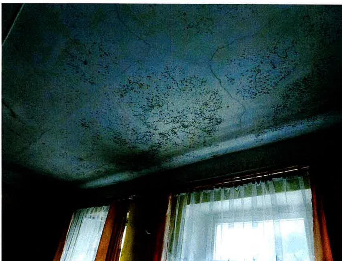
FOT.14 – UGIĘTY I ZARYSOWANY STROP DREWNIANY. WIDOCZNA PLEŚŃ NA ŚCIANACH ORAZ SUFICIE
