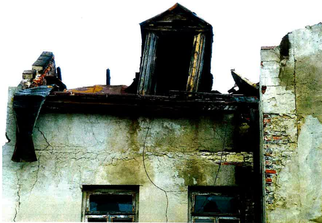
FOT.6 – FRAGMENT SPALONEGO DACHU ŚCIANY WSCHODNEJ
