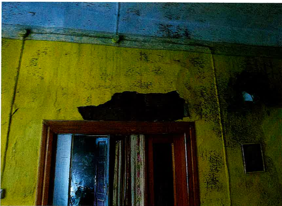
FOT.13 – WYKWITY PLEŚNI NA ŚCIANIE. ODPADAJĄCY TYNK OD ŚCIANY. MUR UŁOŻONY NA PUSTE SPONY
